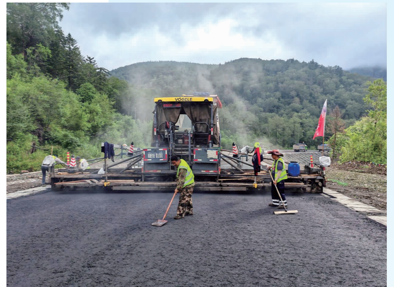
◀ 亚雪项目A1标段K540000-K541500中粒式沥青混凝土AC-20C下面层摊铺施工
